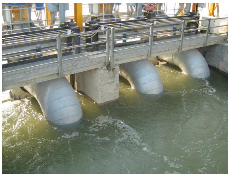
Figura 39 - Impianto di pre-sollevamento di Foce Morbasco.
