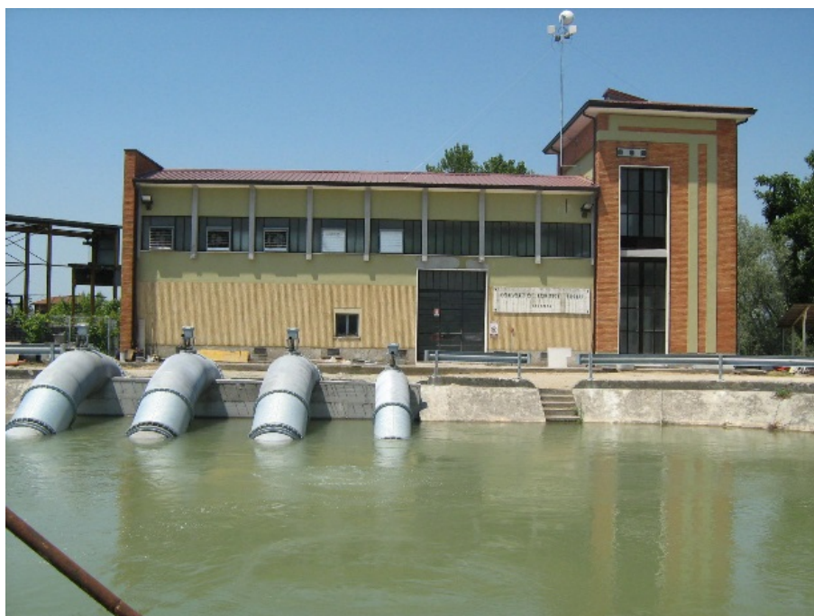
Figura 38 - Impianto di Foce Morbasco.
