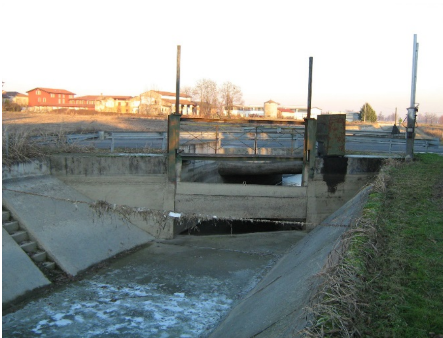
Figura 44 - Sostegno sul canale principale di Foce Morbasco per derivazione Diramatore Stagno.
