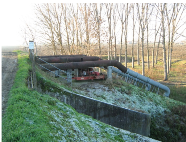
Figura 143 – Impianto idrovro 'Pozzolo'.
