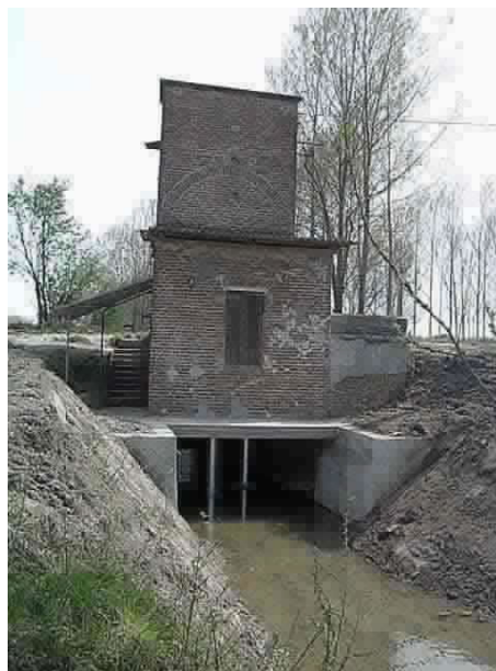
Figura 139 - Impianto idrovoro Monticelli R/Oglio.
