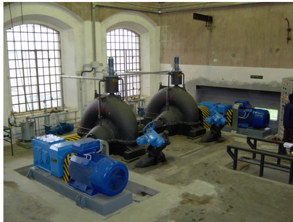
Figura 138 - Impianto di sollevamento S. Paolo R/Oglio.
