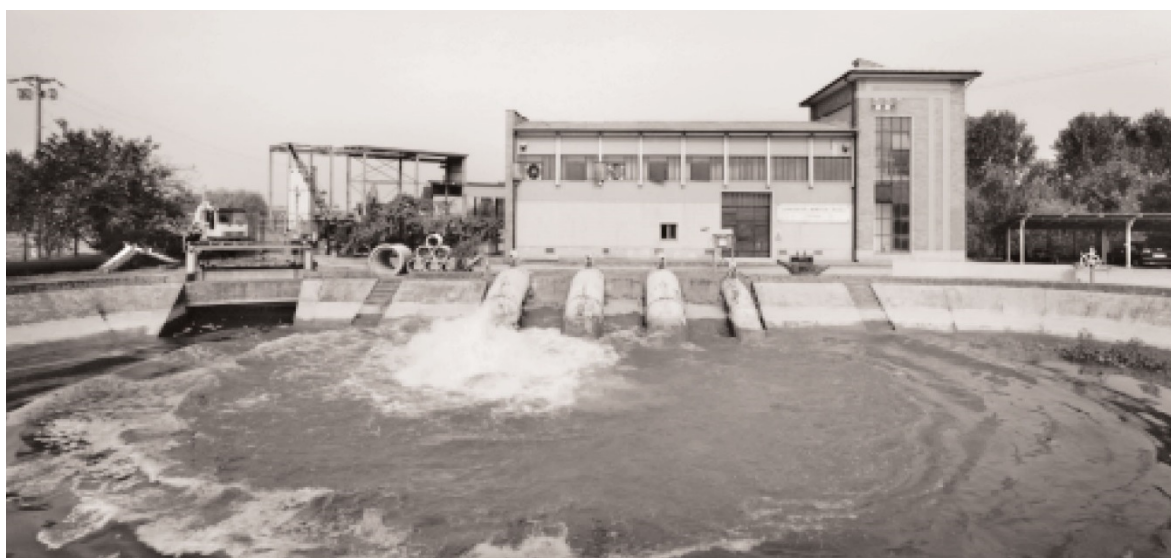
Figura 158 - Impianto di sollevamento di Fuce Morbasco.
